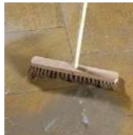
Steg 4. Borsta bort överbliven fogmassa. Om du har släta plattor kan du med fördel använda vatten.
